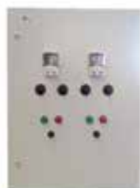
Variador dos motores
