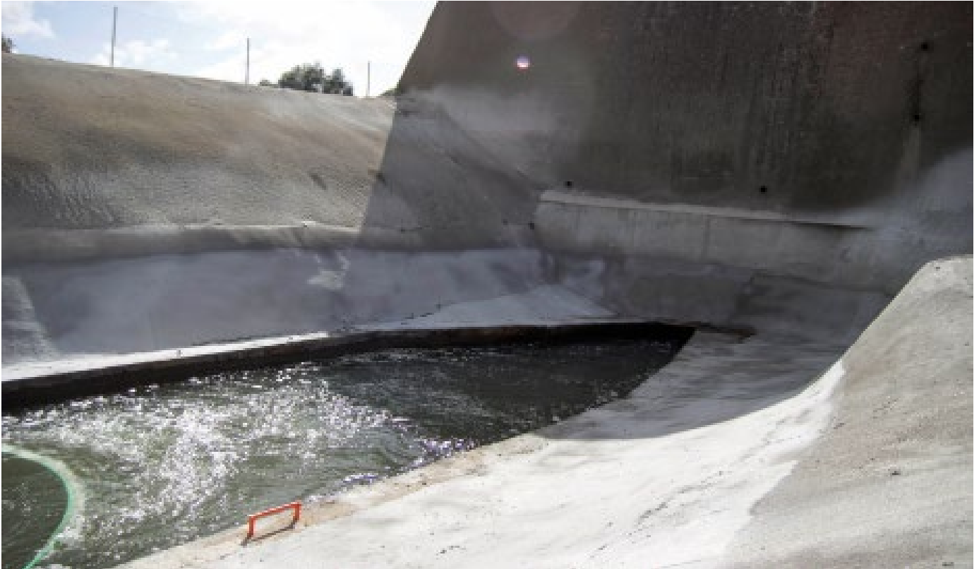
El túnel de San Silvestre necesita una rápida intervención.
